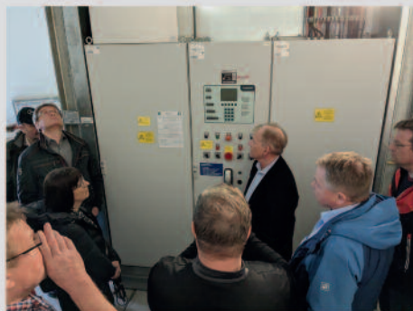
Schalttafel im Inneren eines Windrads
